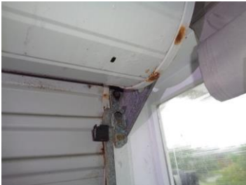
Roller door rusting
