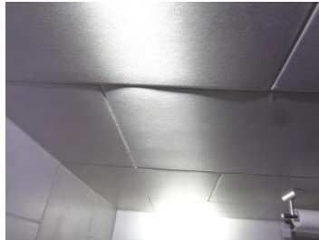
Wall tiles uneven
