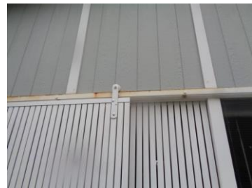
Door guide rusting
