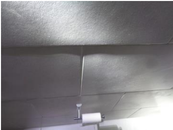
Wall tiles uneven
